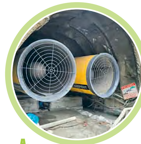
A. Ventiladores en la entrada de la galería de rescate.
