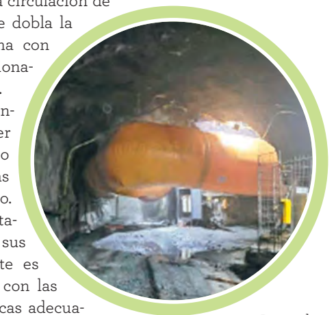
C. Ducto de ventilación que lleva el aire al frente de trabajo del túnel Guillermo Gaviria Echeverri.
